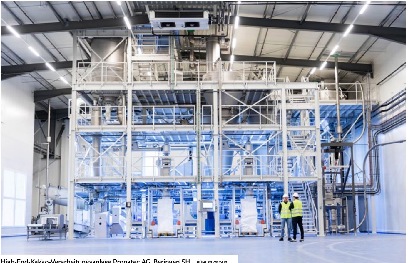
High-End-Kakao-Verarbeitungsanlage Pronatec AG, Beringen SH. BÜHLER GROUP
